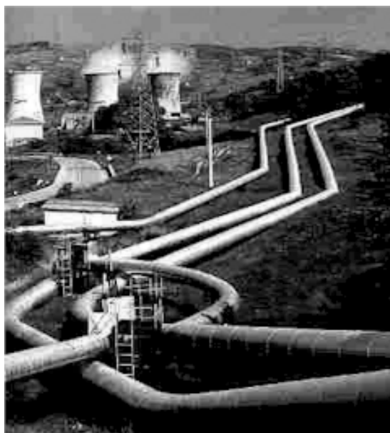
Figura nº 11. Central Geotérmica en Nueva Zelanda.
