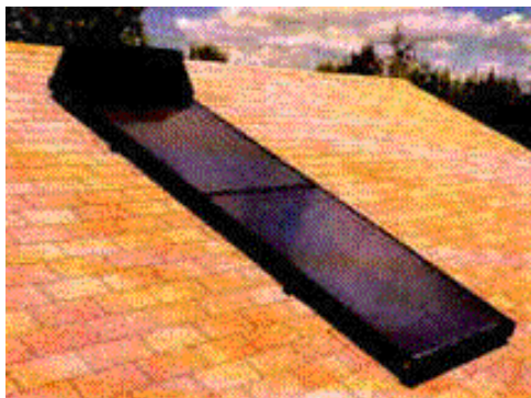
Figura nº 5. Colectores de baja temperatura.
